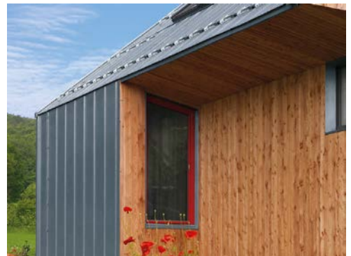
((Datei: 2316-019-A4-RET), Bild: RHEINZINK) Die Sicherheitsvorrichtungen gegen das Herabfallen von Schnee und Eis sind so ausgeführt, dass sie für die Wartung der Fenster mit eingehängten Leitern nutzbar sind.
