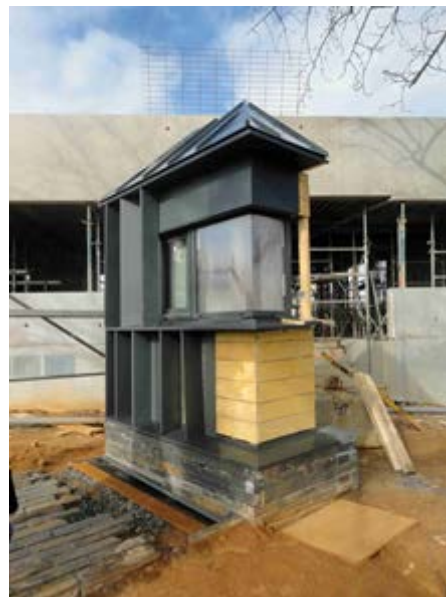
((Datei: (c)a+samueldelmas_chantier_02_DSC06257R)) Ein Modell im Maßstab 1:1 bildete die Grundlage für die modifizierte Ausführung an der Fassade. Foto: a+ samueldelmas_chantier
