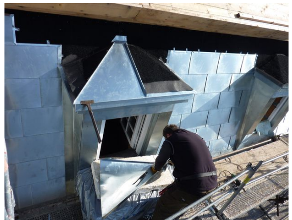
((Datei: P1040485)) Mit großem handwerklichen Geschick und Können wurden die zahlreichen Übergänge an den Schornsteinen, Fenstern sowie den ebenfalls zahlreichen Kehlen ausgeführt. Foto: Kontrakting stavebné montáže/Pluta – Strechy
