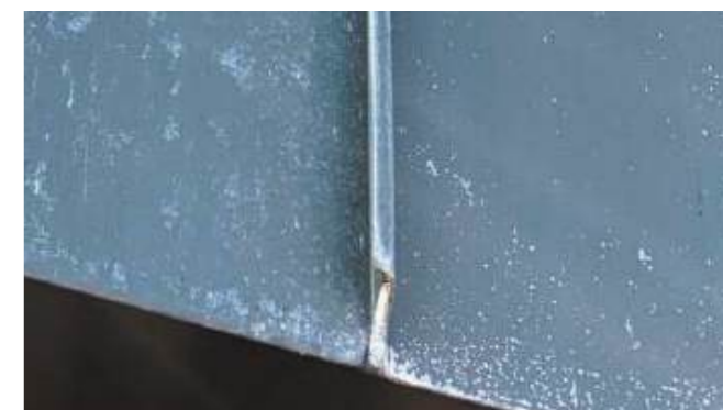
Beispiele für Salzablagerungen auf Fassaden, an Falzen und Tropfkanten
