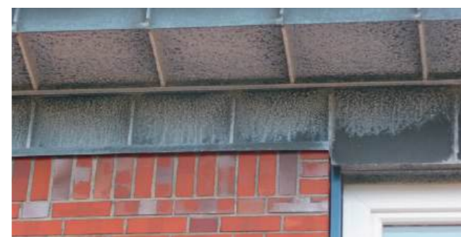
Beispiele für Salzablagerungen an Dachuntersichten und Unterseiten von Dachrinnen
